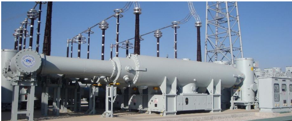
平高生产的1100kV GIS
